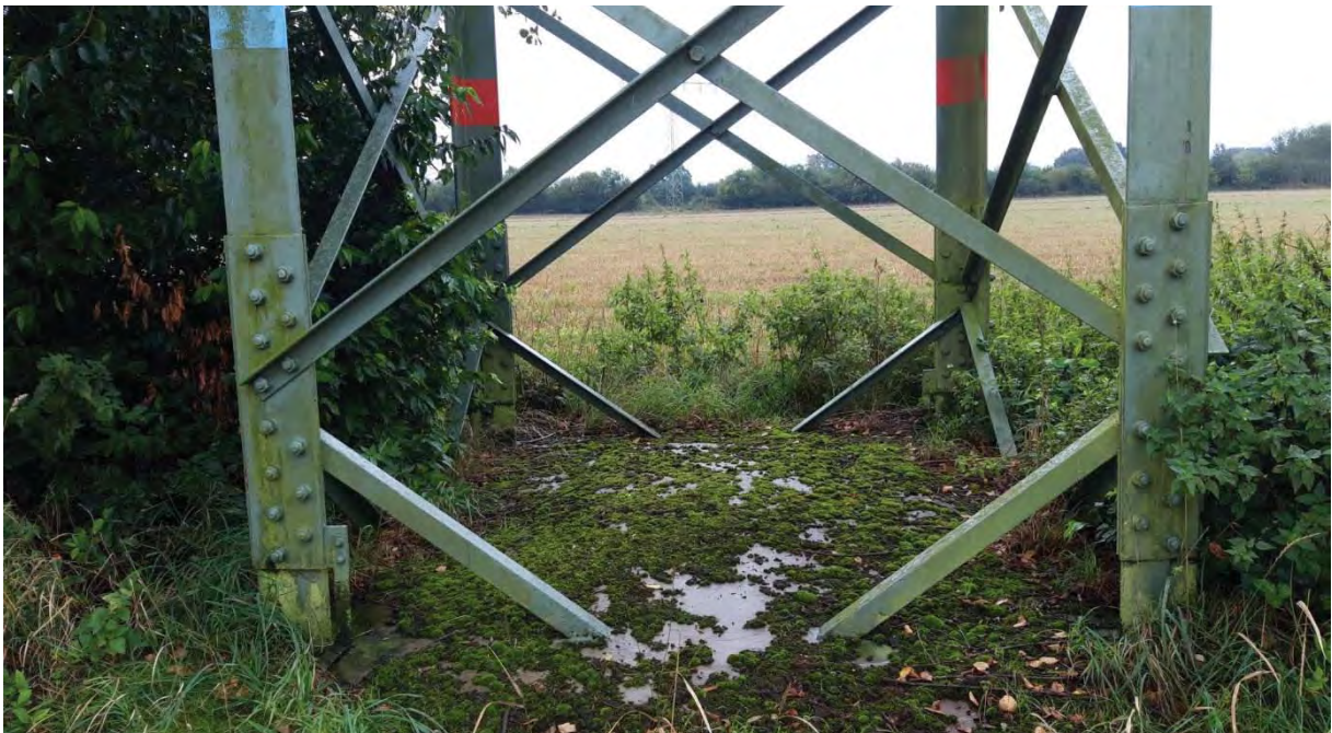
Abbildung 10: Standort eines Strommasten innerhalb des Knicks (Blick nach Süden)
